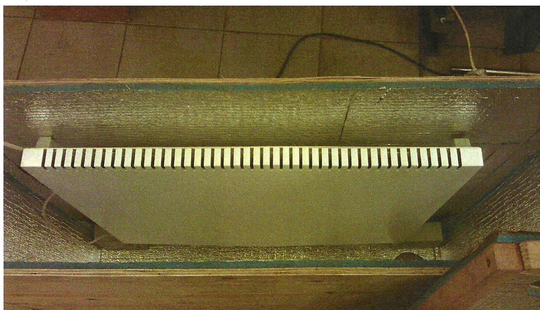
Рис. 6 — Расположение испытуемого электронагревателя в теплоизолированном боксе.
